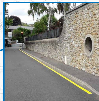
Quai des Platanes Bandes jaunes pour supprimer le stationnement sauvage
